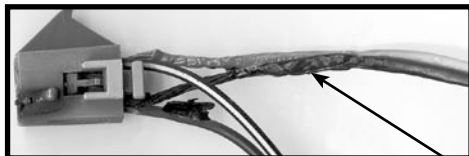
Observe que el cable solamente se ha fundido cerca del conector.
